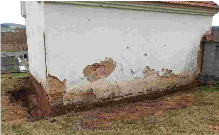
Márnice na hřbitově v Mladoticích před opravou
